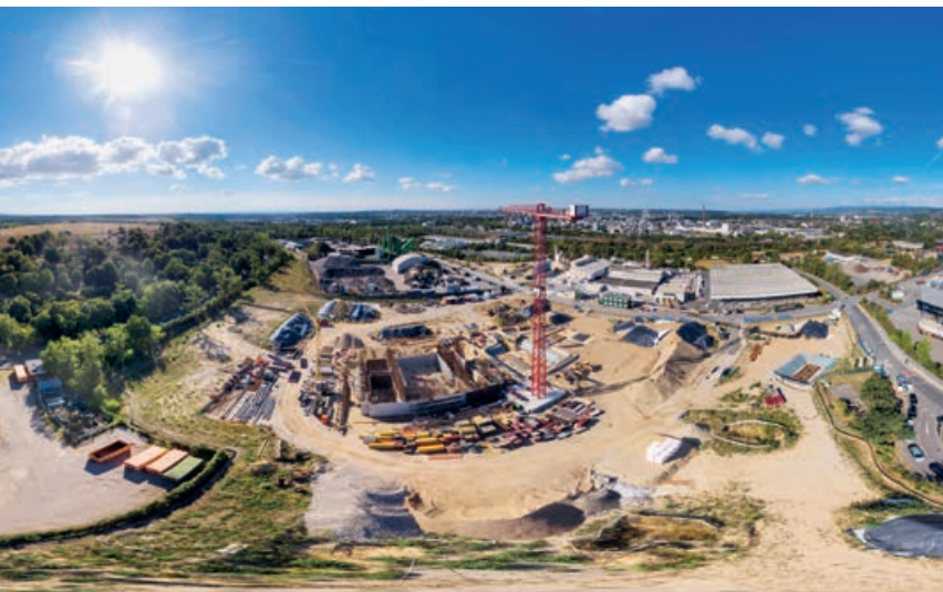
Energie aus eigener Kraft: Das Entsorgungsunternehmen Knettenbrech + Gurdulic baut neben dem bestehenden Biomasseheizkraftwerk noch ein neues Müllheizkraftwerk auf.
